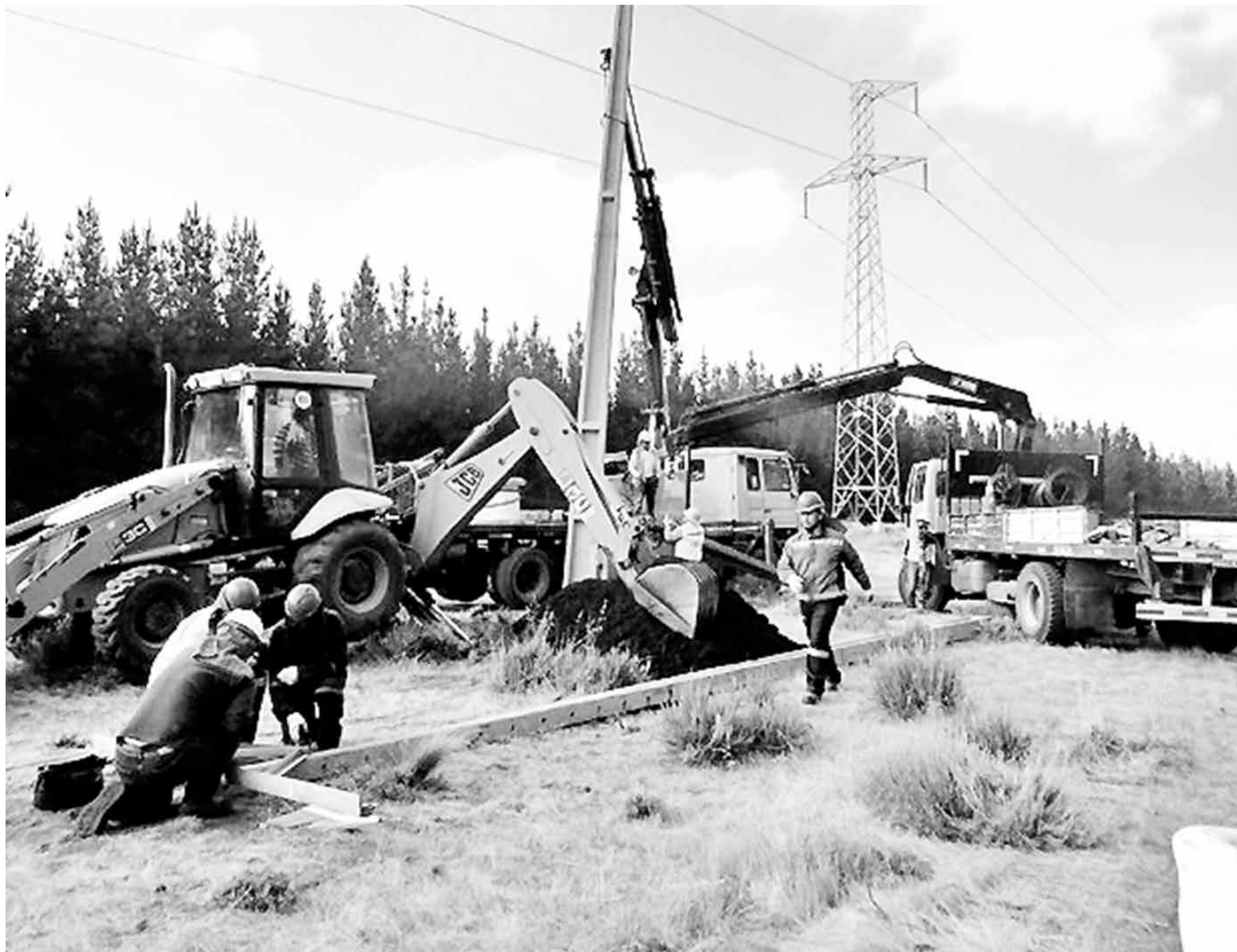
DIVERSAS MEDIDAS se han implementado a fin de aminorar los delitos asociados al robo de cables de cobre. (Imagen de contexto).
