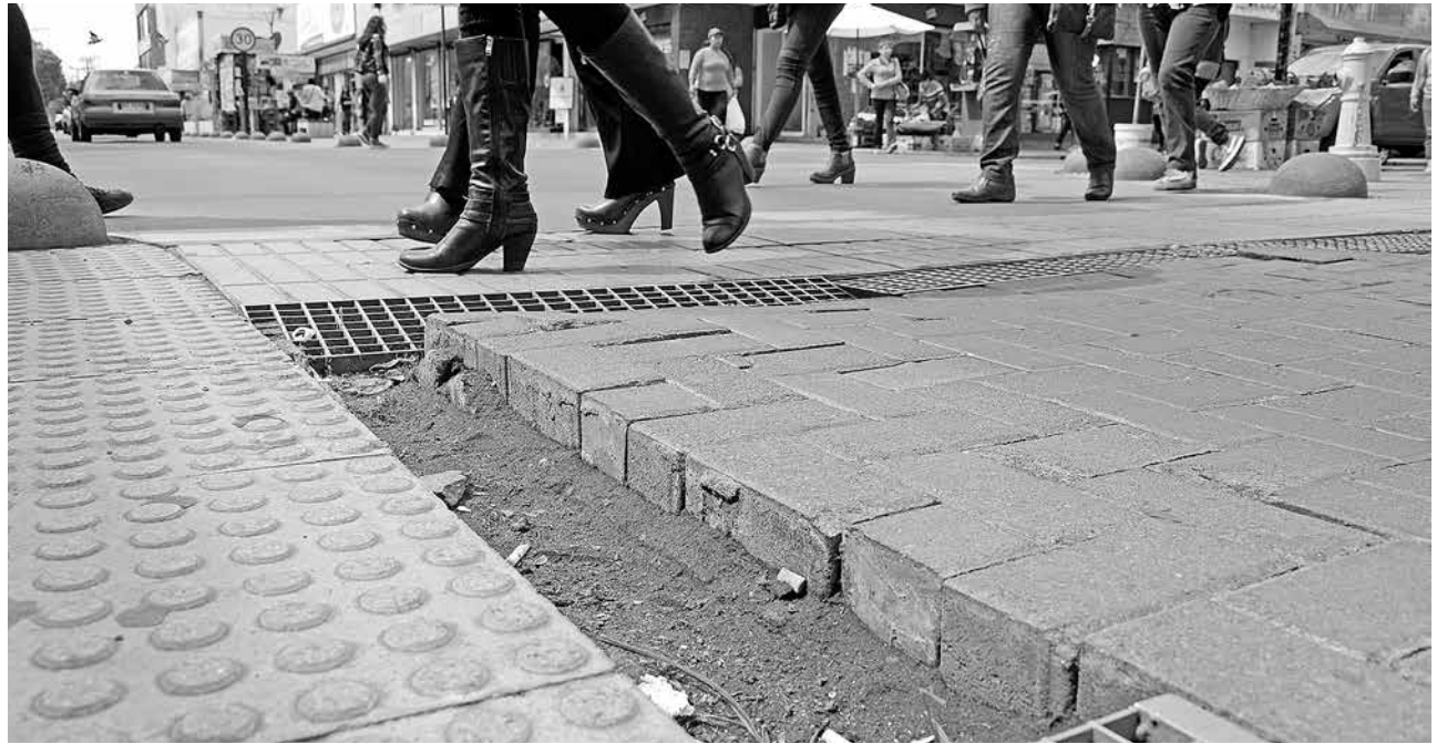
LOS DIVERSOS "EVENTOS" que presenta la obra, ha provocado diversos accidentes en los transeúntes.
