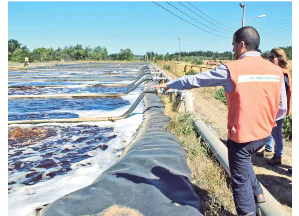
EL RELLENO SANITARIO sostiene tener la tecnología suficiente para causar el menor impacto, como por ejemplo la piscina que retiene los líquidos percolados.
