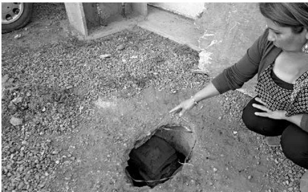
ESTA VEZ, VECINOS descubrieron cámaras de alcantarillado ocultas en las casas.
