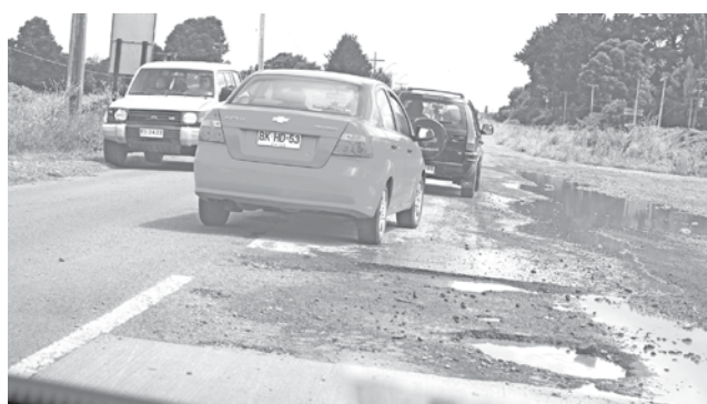
UNO DE LOS SOCAVONES presentes en la ruta, cercano a la Villa La Montaña.
