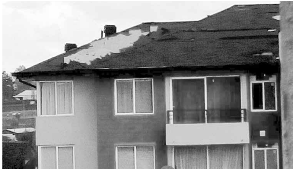
EL SECTOR ALTOS DEL RETIRO tuvo daños en prácticamente todas las viviendas. (Foto ciudadana)
