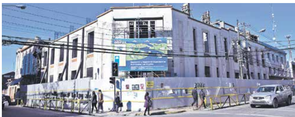
MUNICIPALIDAD DE LOS ÁNGELES excusó la intervención del edificio en daños causados por el terremoto, argumento que ha sido discutido con apreciaciones técnicas y especializadas.
