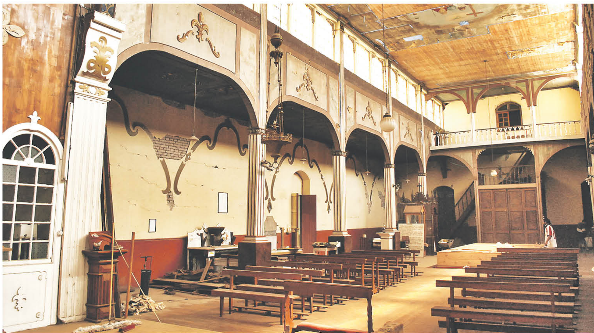
LA ESTRUCTURA se encuentra en malas condiciones desde el terremoto de 2010.
