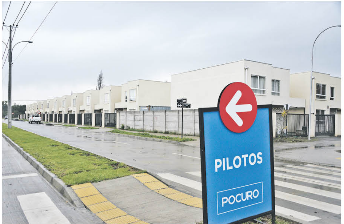
EN MAYO DE ESTE AÑO los habitantes del lujoso condominio Tres Vientos construido por la inmobiliaria Pocuro decidieron hacer pública la situación que vivían en sus casas producto de daños, la empresa aduce post venta y los vecinos perjuicios estructurales. Actualmente están enfrentados en un proceso judicial.
