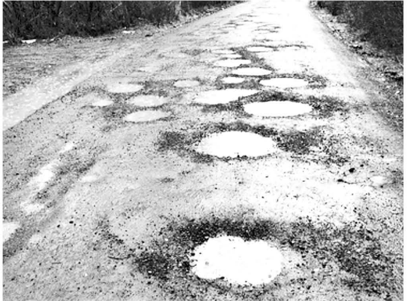
LOS ROBOTS TENDRÁN la capacidad de escanear la ruta y así detectar grietas y daños.
