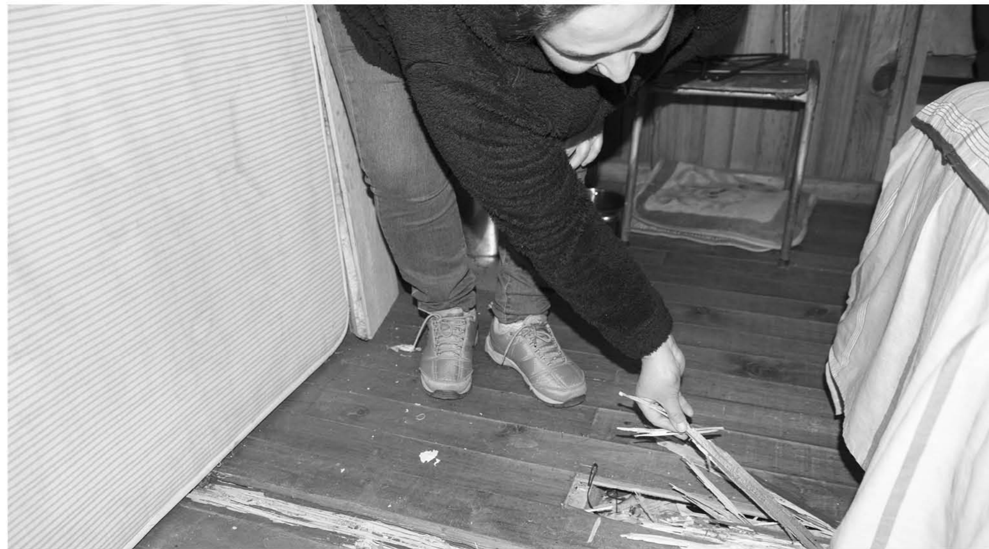
Patricia Arriagada exhibe el estado en el que se encuentra el piso del cuarto de su hija de siete años, ubicado en el segundo nivel de su casa, en la población Entre Ríos.
