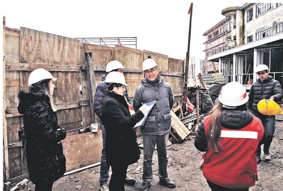
LA DILIGENCIA efectuada por la ministra Villalobos en julio gatilló la paralización de las obras del Centro Cultural, decisión que fue apelada por el equipo jurídico de la municipalidad de Los Angeles lo que convocó esta instancia en Valdivia el jueves.
