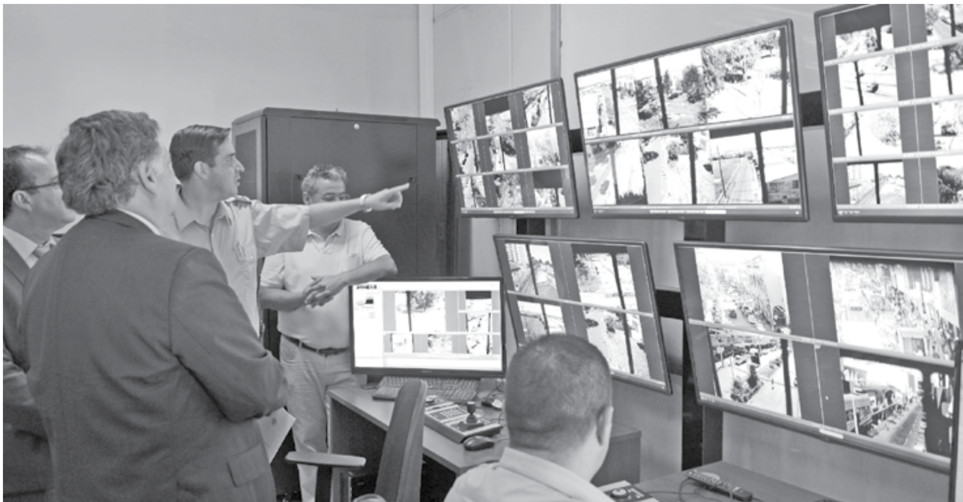
ACTUALMENTE, EL SISTEMA DE CÁMARAS de televigilancias en la comuna se encuentra en un 90% de ejecución, faltando por mejorar sólo algunos detalles.
