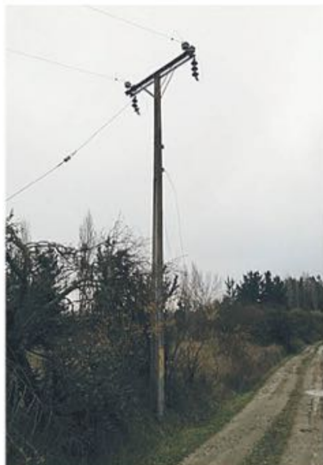
UN TOTAL DE 2.500 METROS de cable fueron robados en esta ocasión, lo que afectó al sector de Paso Hondo.
