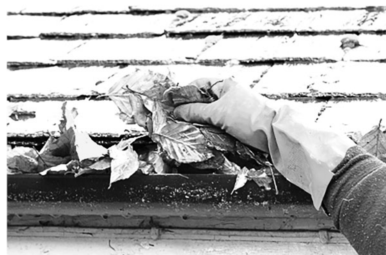
UNA FORMA DE EVITAR que el agua se filtre, es mantener limpias y en buen estado las canaletas de nuestro hogar.
