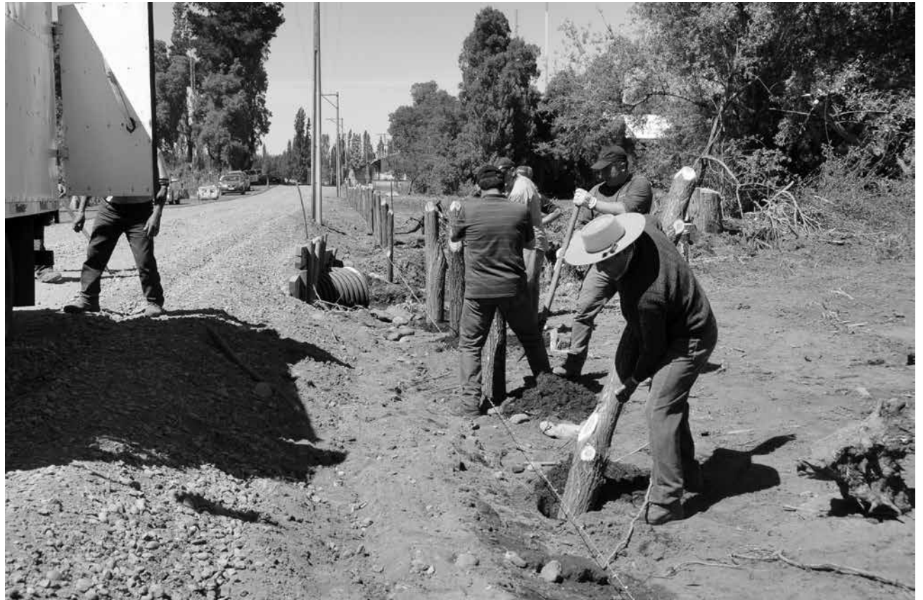
EL COSTO DE LOS MATERIALES y la mano de obra ha sido asumida por los mismos vecinos que conforman el comité.
