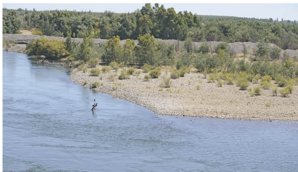
TRAS LA ENTREGA DEL CAMINO, se mantienen los trabajos para disminuir la presión del caudal sobre el lado del socavón (poniente).
