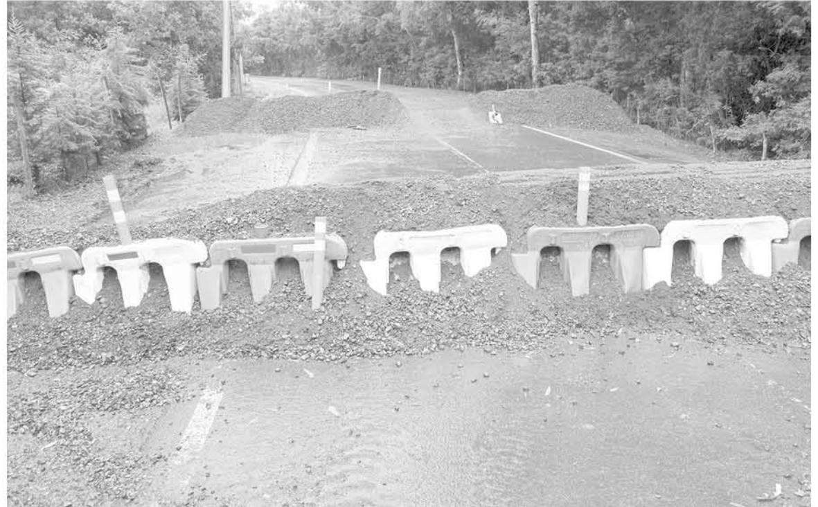
DETALLES EN LAS CONEXIONES entre la nueva y la antigua ruta retrasaron la entrega de la ruta Q-180 en el tramo que une Negrete y Coihue.
