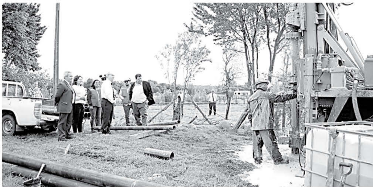
EN TOTAL SE PROYECTA resolver el problema de abastecimiento de agua de consumo humano para el 80 por ciento de la población rural que hoy se abastece con camiones aljibes.
