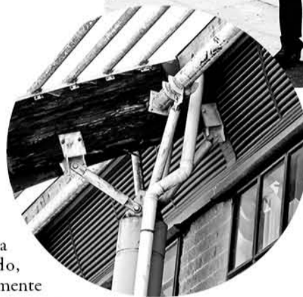
EL DETERIORO ESTÁ A LA VISTA, con vigas que están en un evidente mal estado.
