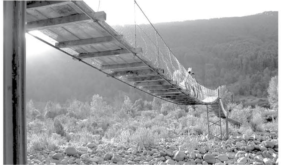
EN EL SECTOR VALLE DE LAS VACAS existen barrancos y acantilados, por lo que se generan accidentes como desbarrancamientos vehiculares
