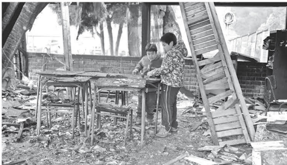
TANTO LA COMUNIDAD EDUCATIVA DE LA ESCUELA, así como los vecinos de Callaqui, han tenido importante participación en el trabajo de reconstrucción.
