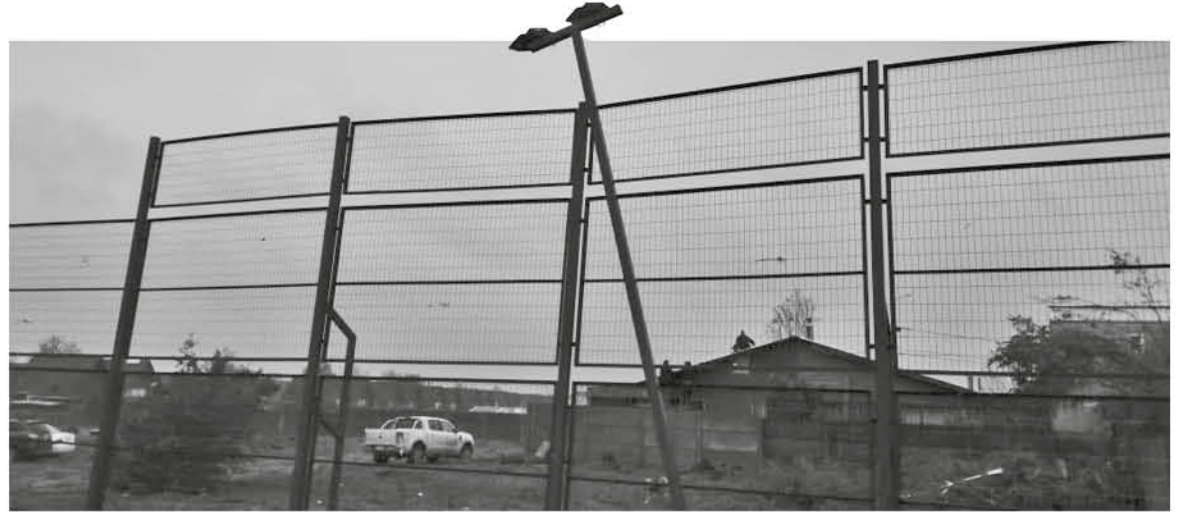
LA MULTICANCHA QUEDÓ con severos daños, entre ellos iluminación en el piso, rejas abiertas, otras dobladas, junto a una construcción inestable.
