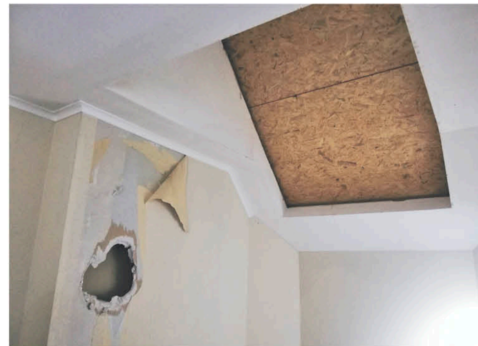
DAÑO INTERIOR de la casa de David Lazo.
