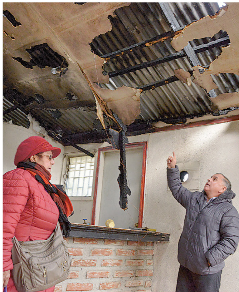
LEONEL DA CUENTA de los daños que sufrió su casa por el incendio.
