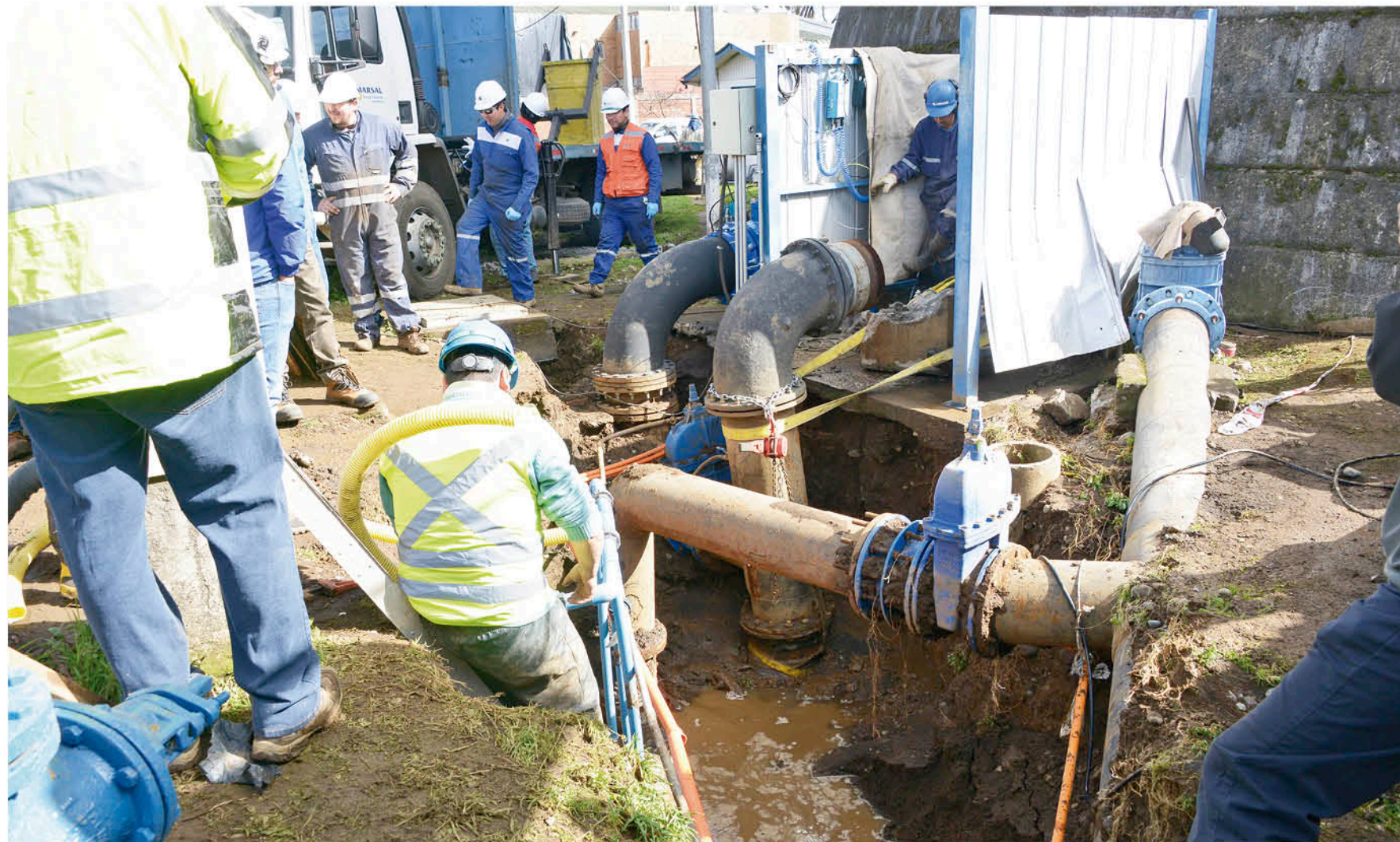
LA FALLA EN LA REPARACIÓN de una cañería importante dejó a veinte mil clientes sin agua durante el día.
