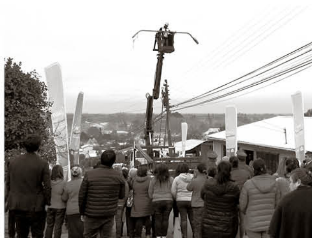
LA NUEVA LUMINARIA del barrio Héctor Dávila permitirá mejorar la calidad de vida de los vecinos y ahorrar al municipio en el pago de la luminaria pública.
