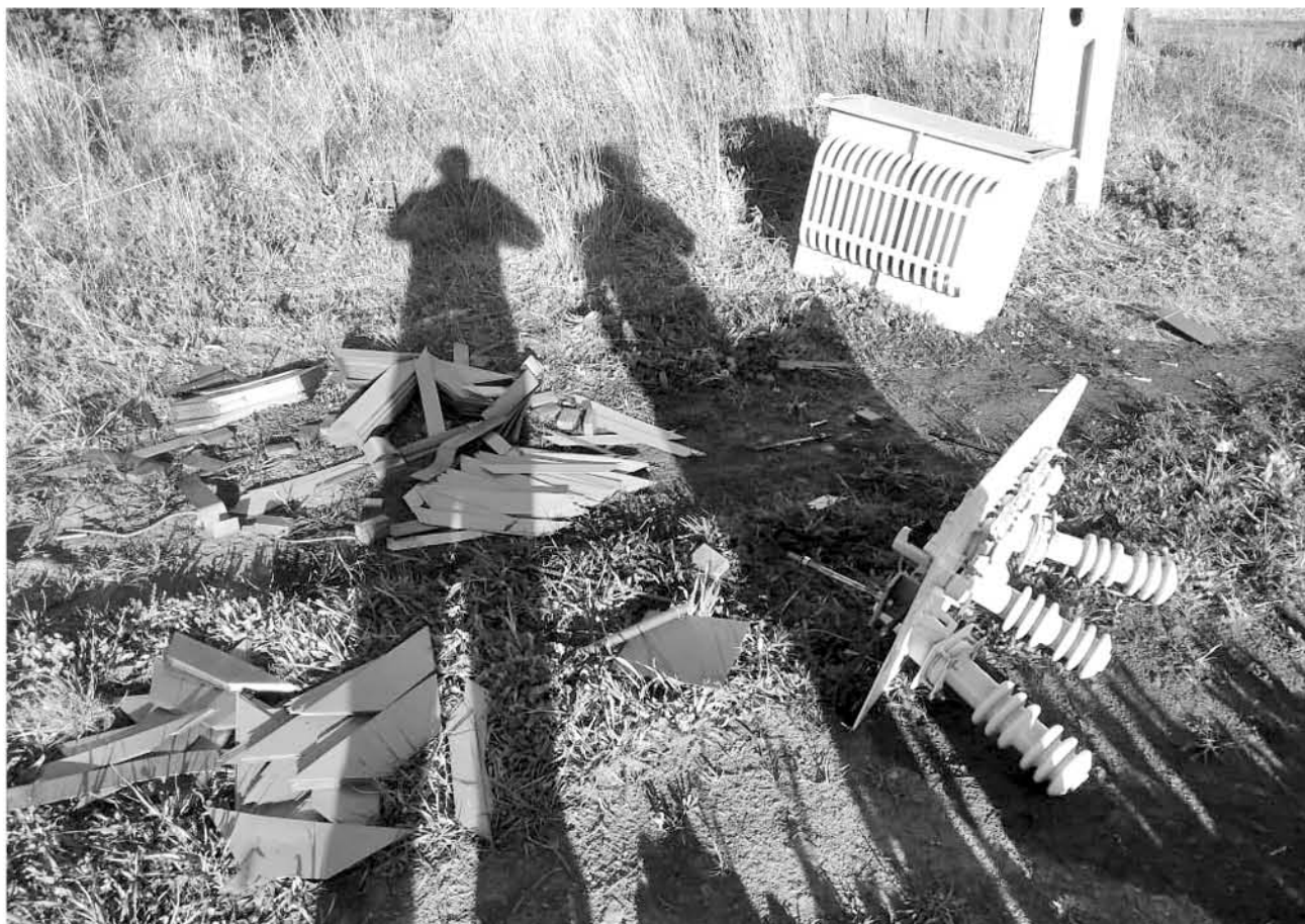
EL ÚLTIMO ROBO realizado en Agrícola Picoltue limitada, donde destruyeron un transformador para sustraer su cobre.
