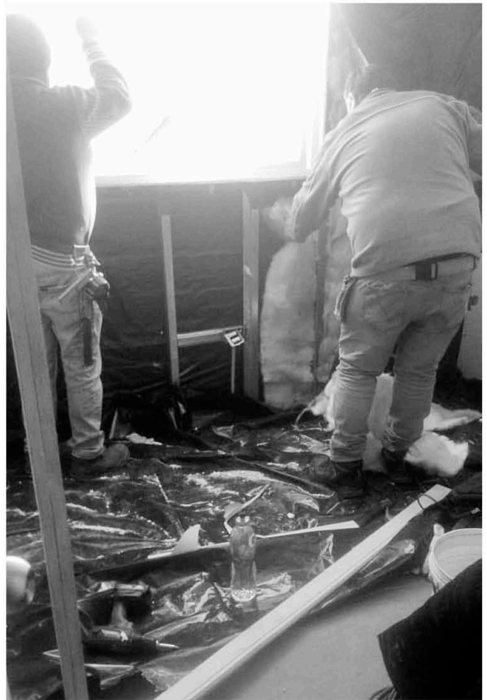
LOS VECINOS HAN CAMBIADO la aislación de sus viviendas sacando el nylon que se utilizó porque argumentan que es un pésimo material y que ya no se utiliza en las construcciones.
