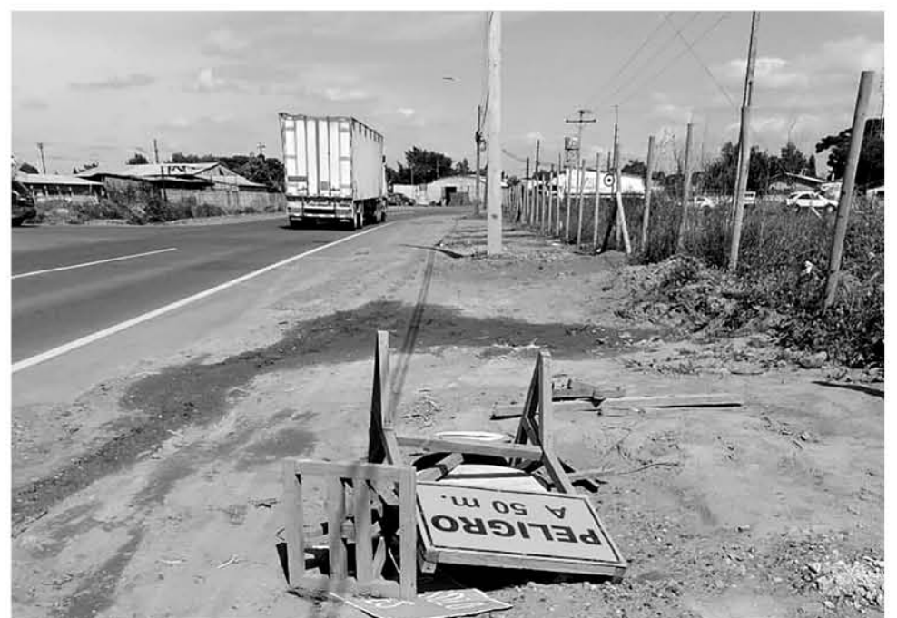
CAMINO A RENAICO según indicó Jorge Hormazábal se encuentran deterioradas las cámaras de alcantarillado.
