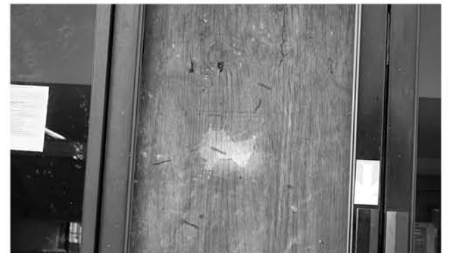
LA GOBERNACIÓN PROVINCIAL también fue atacada con piedras y otros implementos que dañaron su ingreso.
