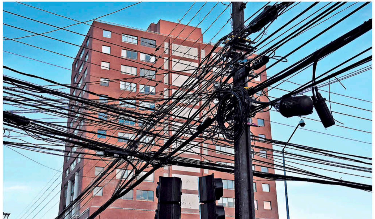
EL RETIRO Y CAMBIO DE LUGAR DE POSTES es un costo que actualmente cubren los municipios al realizar obras.
