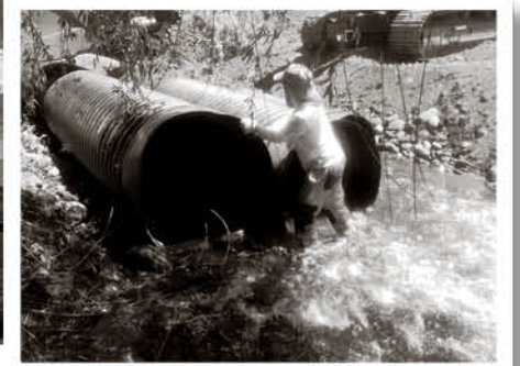
CON APOYO DE MAQUINARIA se logró retirar el camión del puente, tras el accidente ocurrido el sábado al transitar un camión con una carga mayor a la autorizada.
