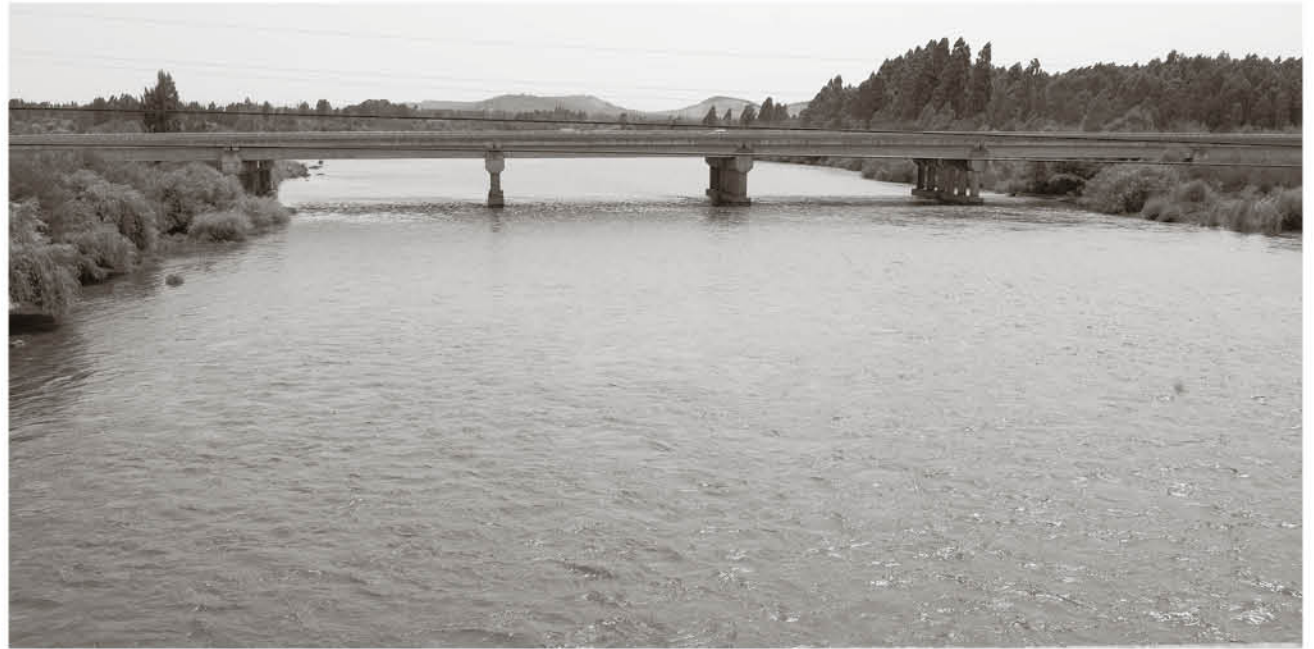
LAS AGUAS DEL RÍO BIOBÍO se volverán a usar para alimentar una central hidroeléctrica, esta vez en las cercanías de la localidad de San Carlos de Purén. La imagen muestra el antiguo puente sobre ese curso fluvial, que data de 1940.
