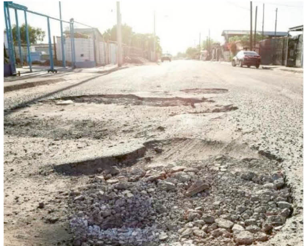
VARIAS CALLES Y PASAJES de la ciudad serán repavimentados gracias a la aprobación de cuatro proyectos por parte del Ministerio de Vivienda.
