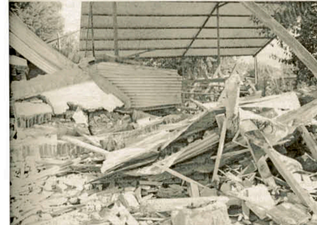
La gran dimensión de los trozos de muralla que cayeron desde el segundo piso, sumado a la violencia del terremoto, no solo destruyeron por completo la sede, sino que, además, estuvieron a punto de desplomar un lado de la techumbre de la cancha.
