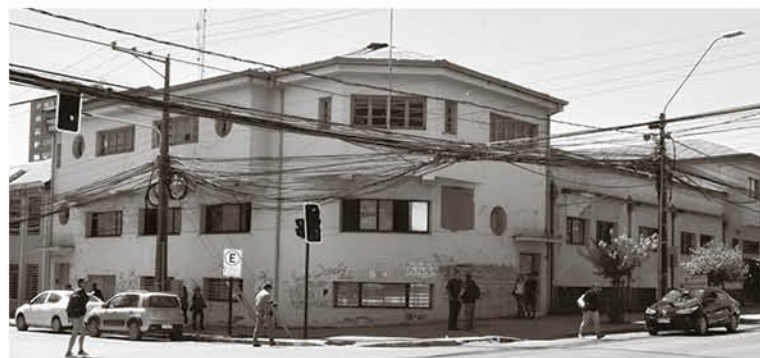
EL EDIFICIO DEL INSTITUTO de Previsión Social (IPS) muestra las consecuencias del terremoto de hace una década.
