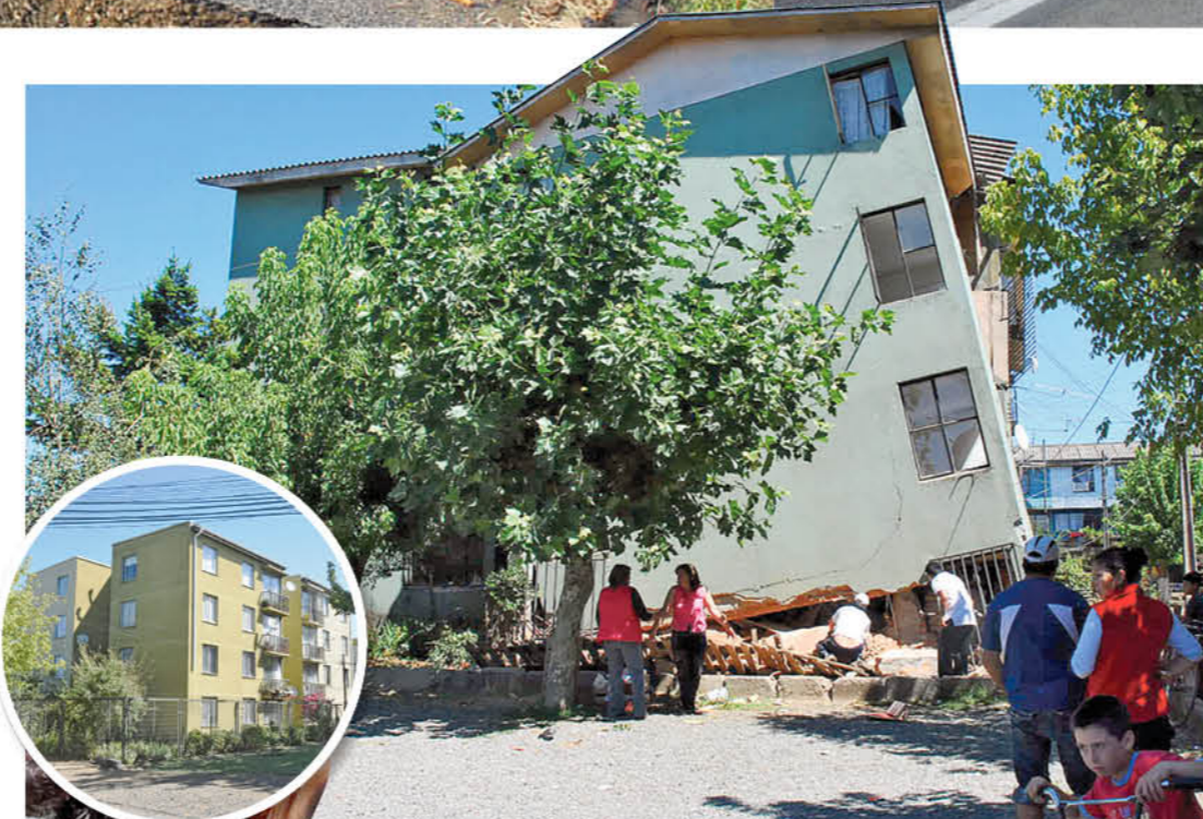
EL COLAPSO DEL PRIMER PISO de uno de los edificios de departamentos de la calle Galvarino fue una de las imágenes más dramáticas del terremoto. Al cabo, el conjunto fue demolido en su totalidad y sus propietarios recibieron nuevos departamentos.
