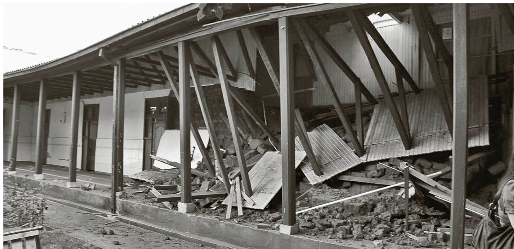
LA PARROQUIA SAN SEBASTIÁN es Monumento Nacional y hasta ahora no ha podido ser reparada tras los daños de 2010.
