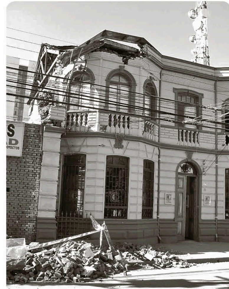
EN 2010, el terremoto derribó las últimas construcciones de principios de siglo que aún permanecían en pie.
