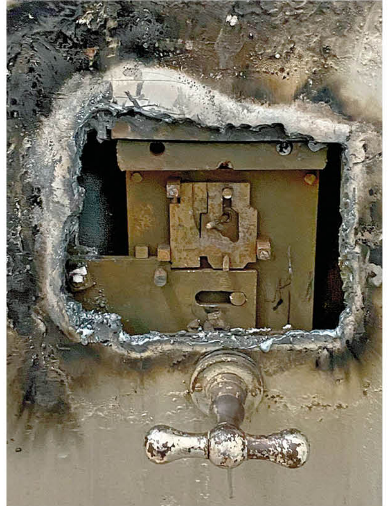
USARON EQUIPOS de oxiacorte para forzar los sistemas de seguridad y una de las dos puertas metálicas de acceso a las instalaciones.
