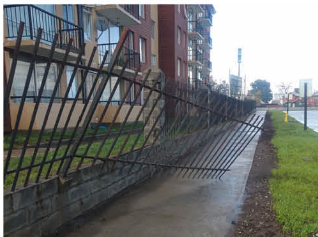
EL 13 DE AGOSTO DEL 2017 los vecinos del condominio sufrieron la caída del cierre perimetral, pese a que se trata de una reja de hierro.
