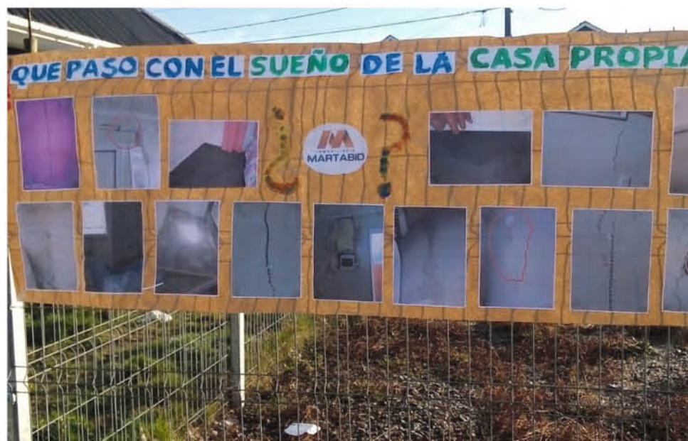
LAS CRÍTICAS DE LOS VECINOS arrojaron en contra de la empresa constructora.
