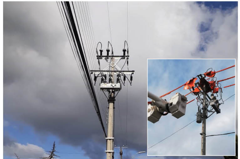
EL NUEVO EQUIPAMIENTO permitirá reconfigurar el sistema eléctrico y sólo un número acotado de clientes se mantendrán sin luz mientras se repara la falla y se reestablece el suministro.
