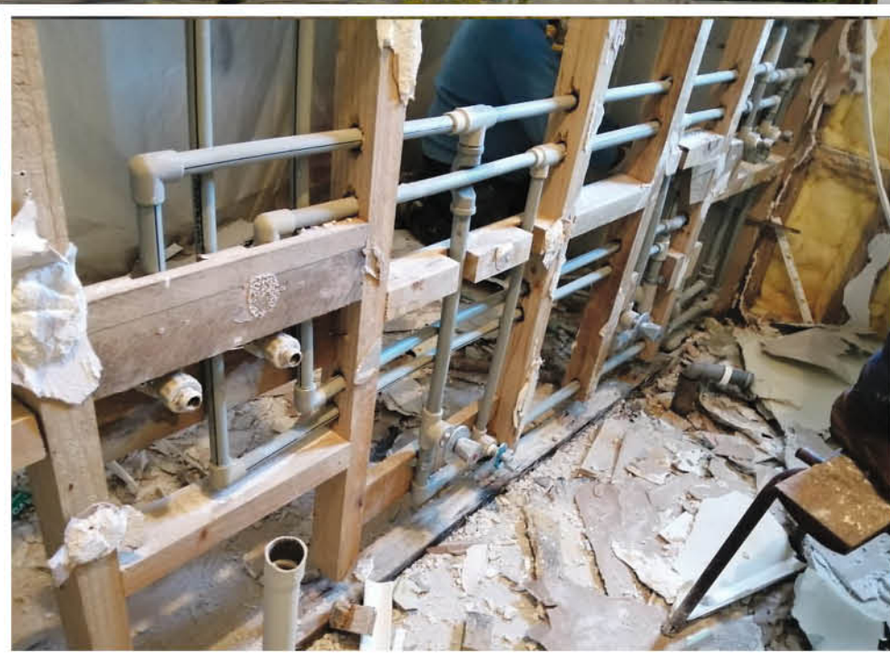
VARIAS VIVIENDAS HAN DEBIDO ser sometidas a profundas reparaciones por las fallas encontradas en su construcción.
