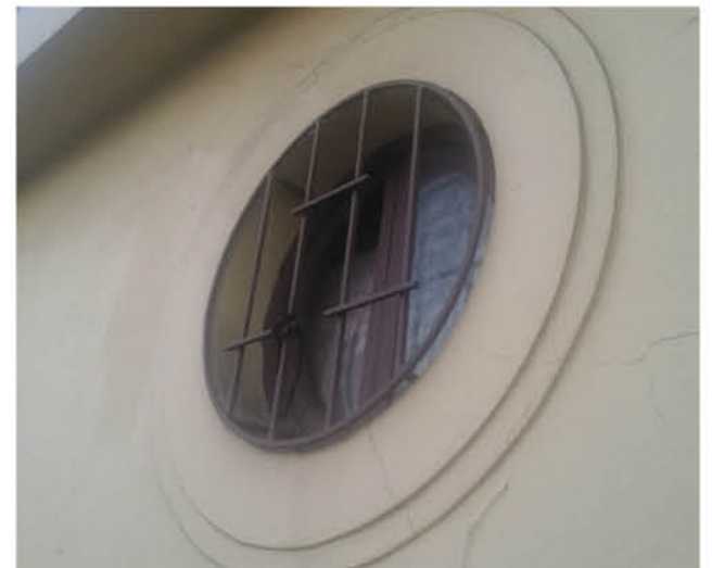
LOS OJOS DE BUEY FUERON una característica de las construcciones de Nibaldo Álamos.
