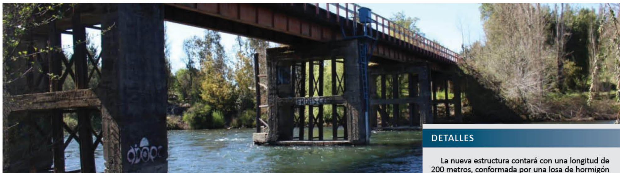
LA ACTUAL ESTRUCTURA es unidireccional y sólo permite el tránsito de camiones con un máximo de 10 toneladas.
