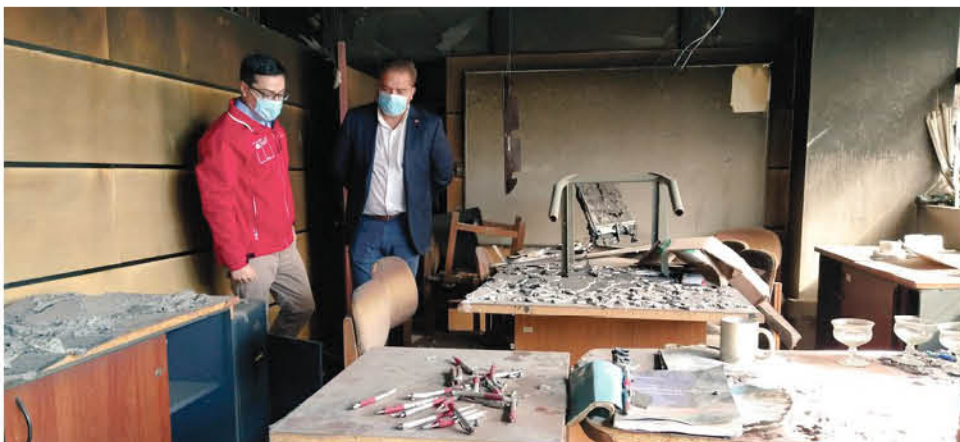
LA DEMOLICIÓN DE MUROS correspondientes al primer y segundo piso y la reparación de la red de alcantarillado son algunos de los trabajos que comenzaron a realizarse.
