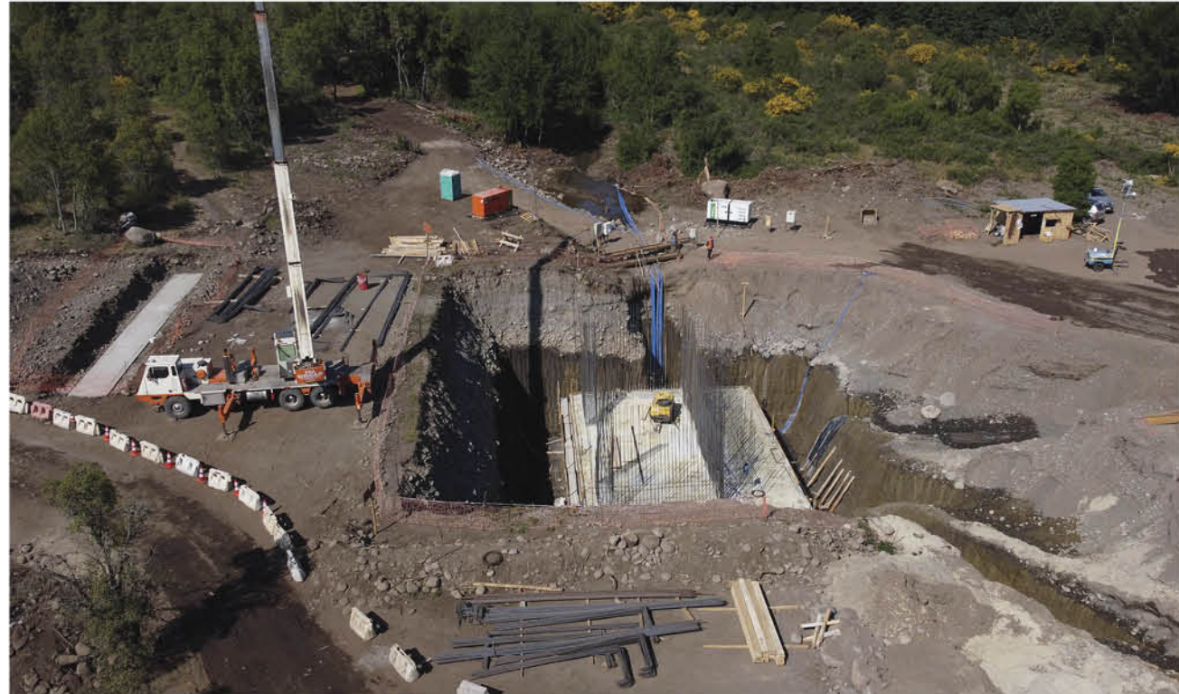
LA NUEVA RUTA, que comenzó su construcción el pasado mes de octubre, debiera obtener su puesta en servicio en el año 2023.
