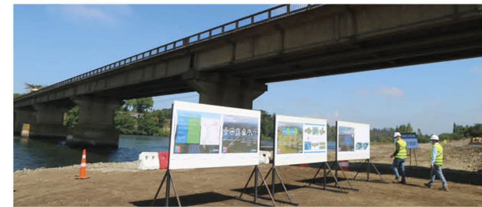
LA PROGRAMACIÓN DE LAS OBRAS contempla la construcción del nuevo puente Coihue, sobre el río Bío Bío, el cual se emplaza inmediatamente aguas arriba, del ya existente, y tendrá una longitud de 564,6 metros.
